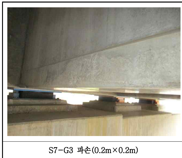
【사진 18.3.5】 거더 손상현황
