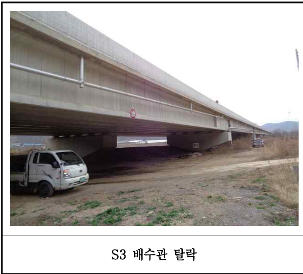
【사진 18.3.22】 배수시설 손상현황
