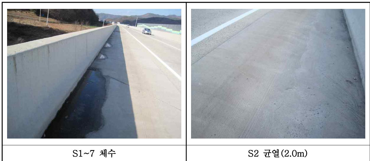
【사진 18.3.43】 교면포장 손상현황
