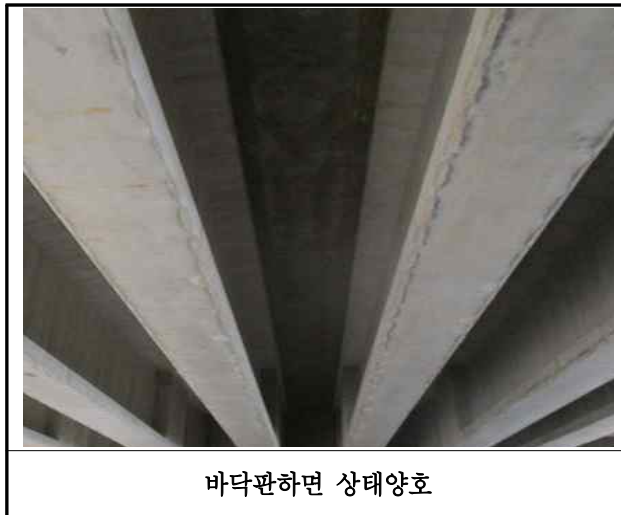
【사진 18.3.26】 바닥판하면 손상현황
